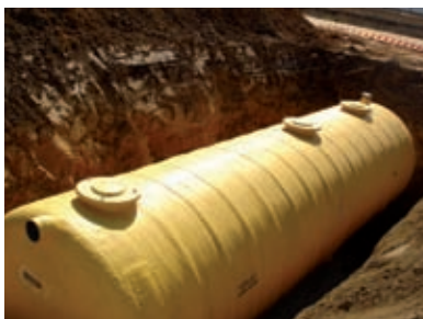
Compacto Fosa Filtro para 200 habitantes en Cáceres (Extremadura)
