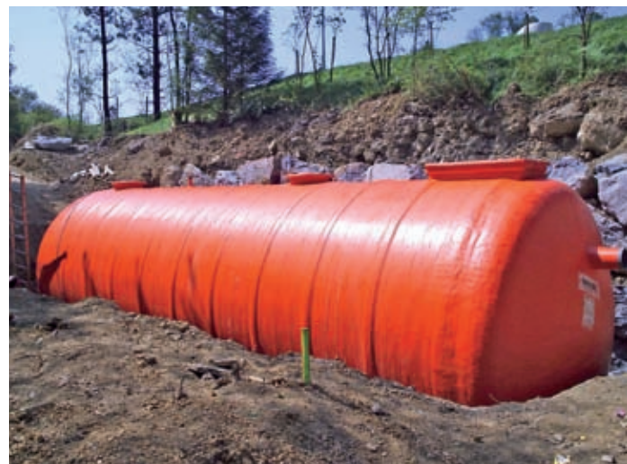
Instalación de una Rox 250 en Toulouse (Francia)
