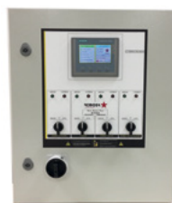
Quadro elétrico de 20 - 500
